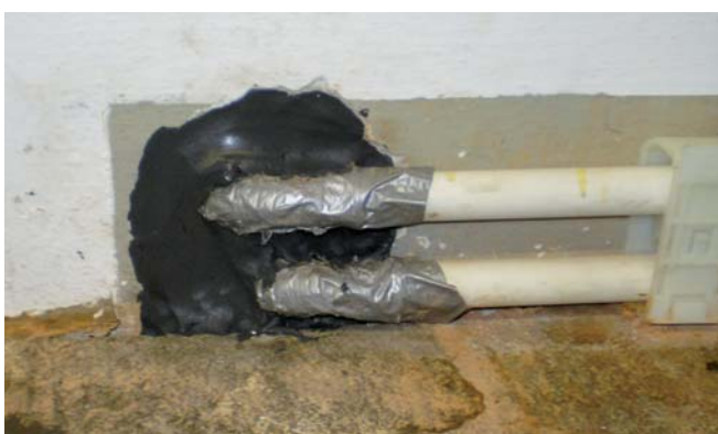
FIWA mit Heizungsrohren
